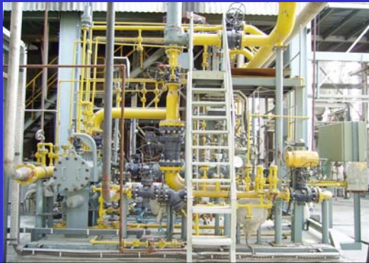
LNG Control Station in Amm.- I Plant
