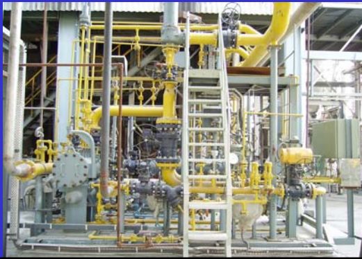
LNG Control Station in Amm.- I Plant
